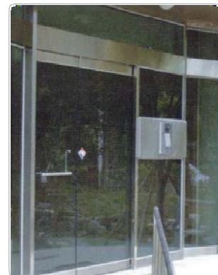
Entrance door for the apartment 아파트 출입통제 자동문
